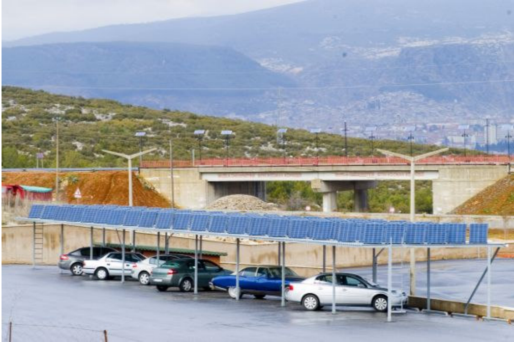
Şekil 6.13 Muğla Üniversitesi otopark alanı çatısında kurulu PV sistem [3]
