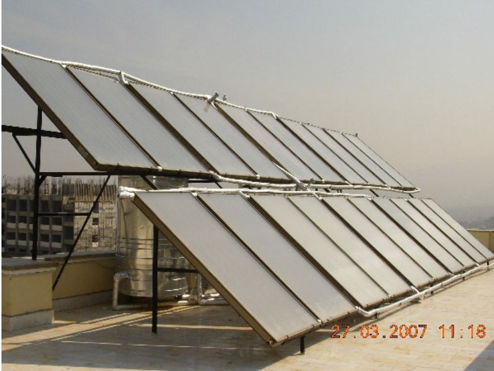
Şekil 6.7. Temiz enerji evi ısıtma panelleri [4]
