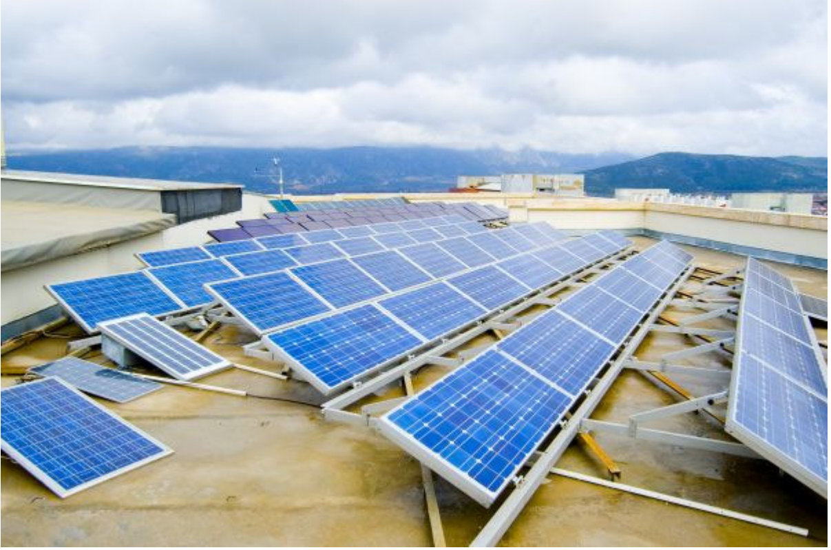
Şekil 6.11 Muğla Üniversitesi merkez kütüphane çatısında kurulu PV sistem [3]
