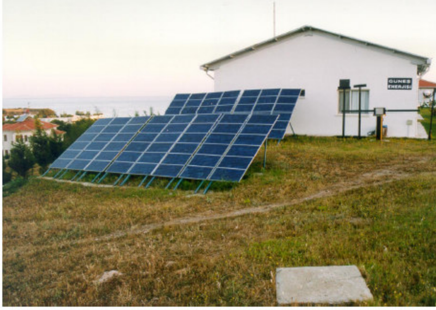
Şekil 6.5 Didim’deki fotovoltaiik sistem [1]
