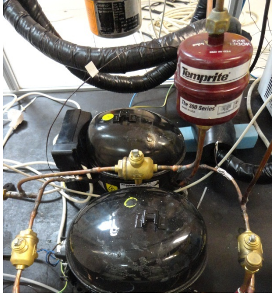
Şekil 3.15 Paralel bağlı kompresörlerin fotoğrafı
