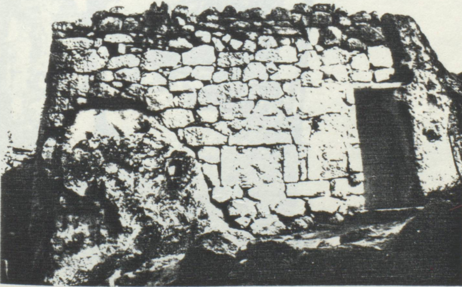
Resim No.46: Kaya artı yiğma yapı
