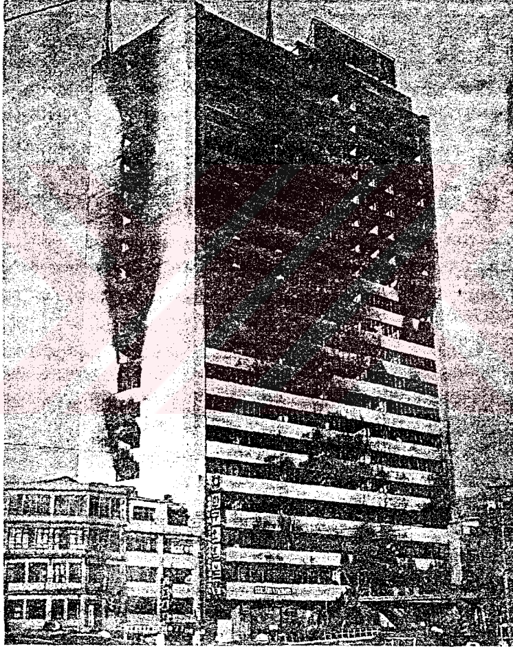
Resim 3.2 Otel Hizmet Birimlerinden Kaynaklanan Yangın (Tae Yon Kak Oteli, Seul, Kore) (Kaynak : BUILDINGS and FIRE)
