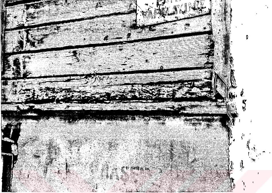
Nem etkisiyle çürümüş bir ahşap ev cephe detayı ( Yeldeğirmeni, Kadıköy ) (Bölüm 3.1.1.1 )
