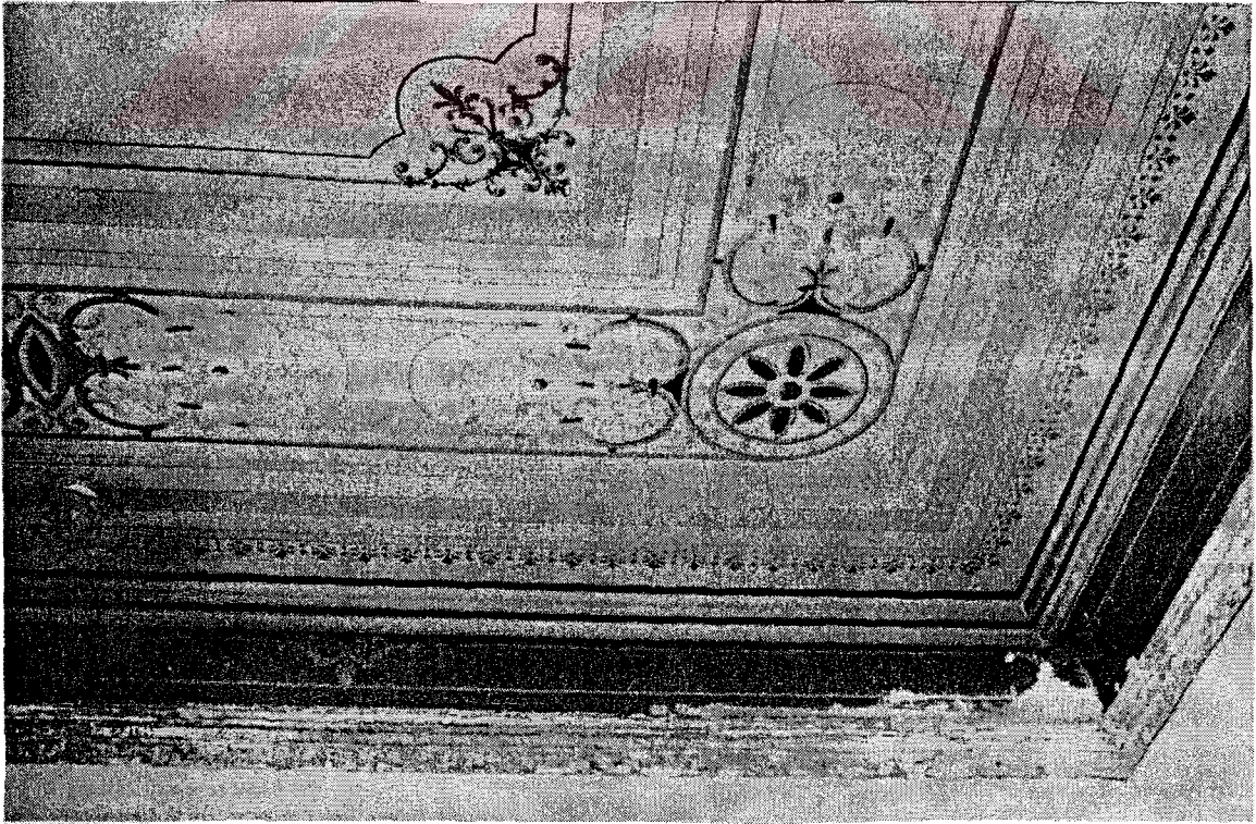
Resim 4.100 Restorasyon öncesinde Z13 no'lu mekanda bulunan mevcut tavan bezemesi
