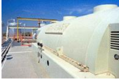
Şekil 3.40 Elektrik santrali jeneratörü, Kaliforniya [26]
