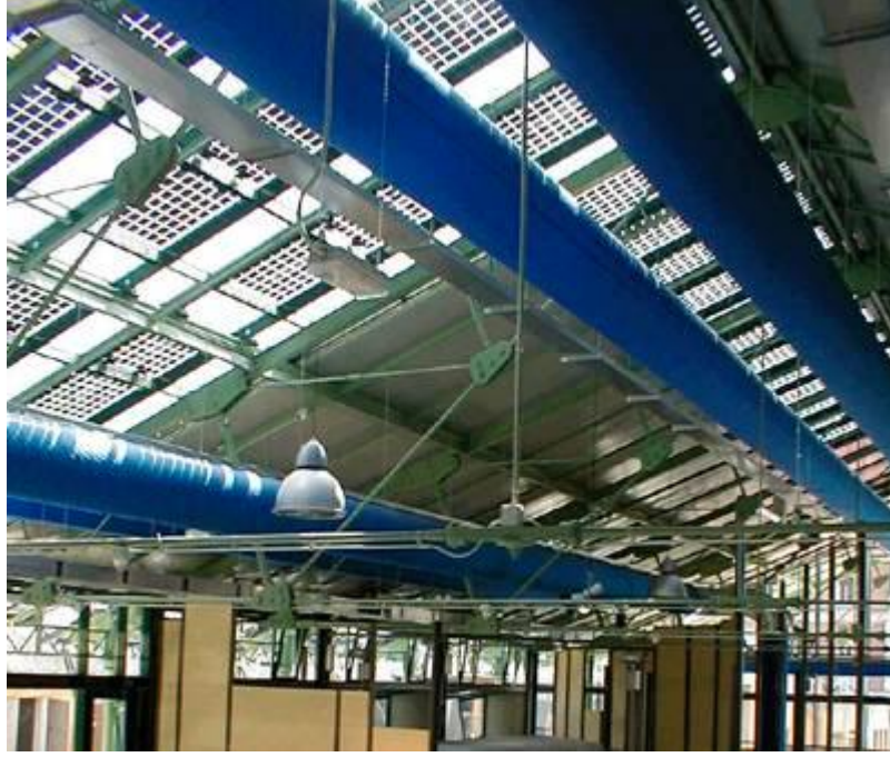
Şekil 3.12 Çatıdaki fotovoltaik modüllerin aşağıdan görünüşü [15]
