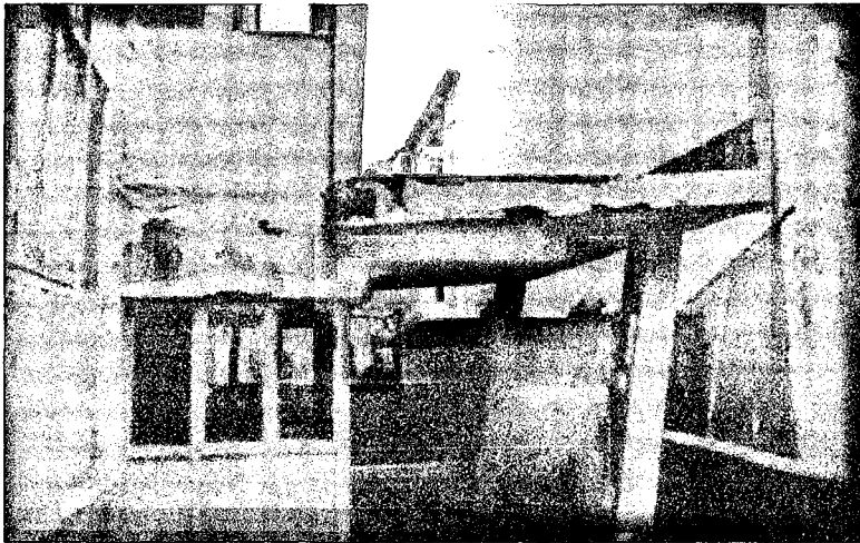
Şekil 4.13 İl İmar Toplu Konutu'nda dış cephede meydana gelen sıva dökülmeleri ve çatlaklar
