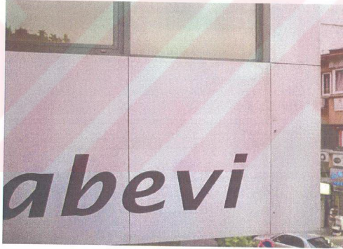
Şekil 4.12 Alüminyum levha kaplamada kullanıcılar tarafından tanıtım panosu yerleştirilmek üzere açılmış vida delikleri nedeniyle oluşan sorun
