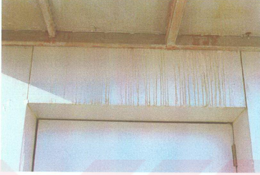
Şekil 4.2 Alüminyum levha kaplama ile farklı özellikteki taşıyıcı bir malzemenin birlikte kullanılması ile gerçekleşen korozyon oluşumu
