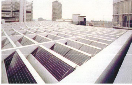
Şekil 5.34. Giriş saçağı üzerindeki fotovoltaik paneller [5]
