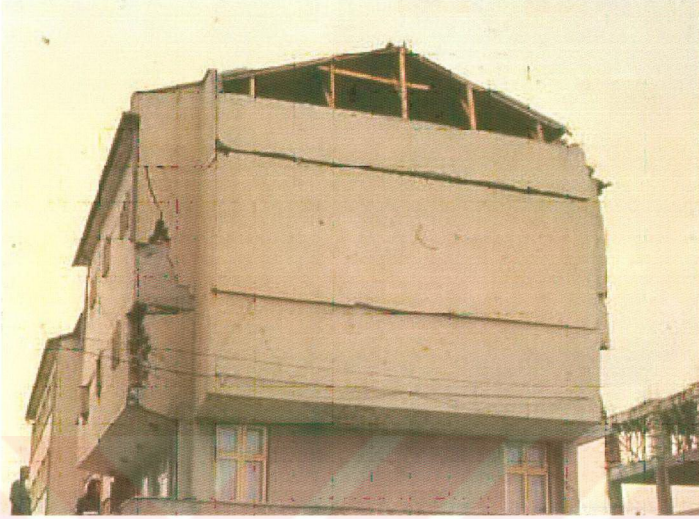
Şekil 3.4 Düzlemi dışına çıkmış duvar (Arun, 2004)
