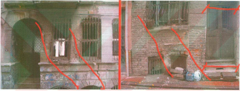
Şekil 4.3 Zemin oturmaları ve malzemedeki çekmelerden dolayı çatlamlar
