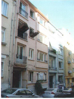
Şekil 5.28 Yıkılmak üzere olan ikinci kuşak apartman
