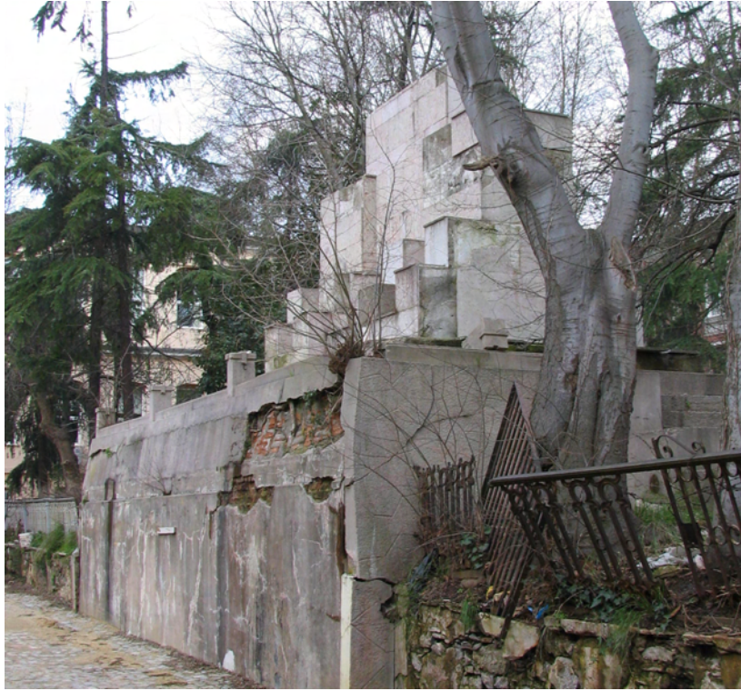
Resim 4.101 Büstün altında sarnıç olarak kullanıldığı sanılan hacme ait tuğla duvar kısmen gözükmektedir
