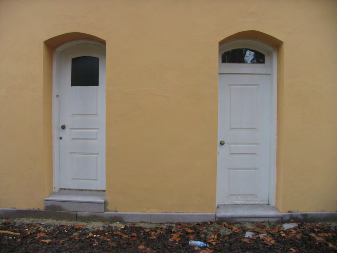
Resim 4.75 B-215 (sağdaki) ve 217 (soldaki) nolu mekanlara ait dış kapılar (restorasyon uygulaması sonrası fotoğrafıdır)
