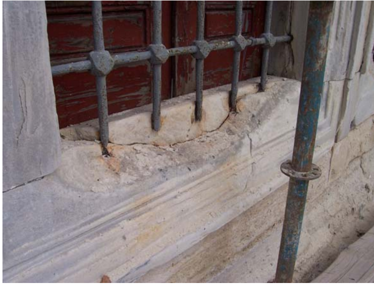
Resim 3.33. Nuruosmaniye Camii zemin kat penceresi dış söve hasarları (oksidasyon)
