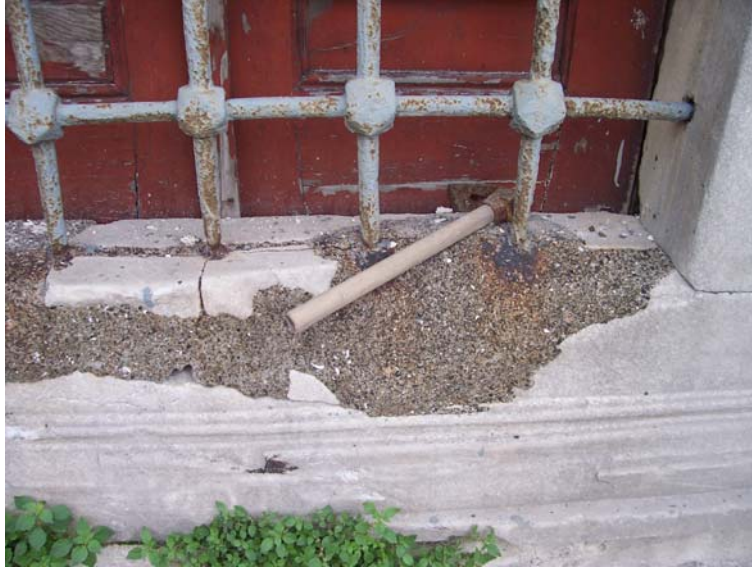
Resim 3.34. Nuruosmaniye Camii avlu duvarı penceresinde yanlış uygulama
