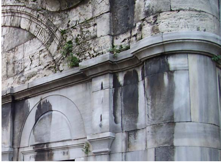
Resim 3.30. Kufeki taşındaki hasarlar
