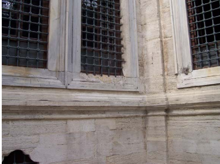
Resim 3.32. Nuruosmaniye Camii zemin kat penceresi dıř sve hasarları
