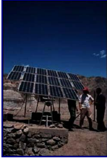
Şekil 3.30 Okulun tüm enerji ihtiyacını karşılayan fotovoltaiiklerden görünüm
