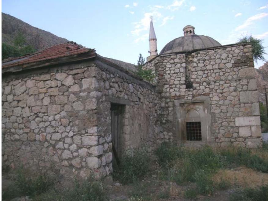
Şekil 6.74 Hamamın batı cephesi üzerindeki muhdes baca boşluğu
