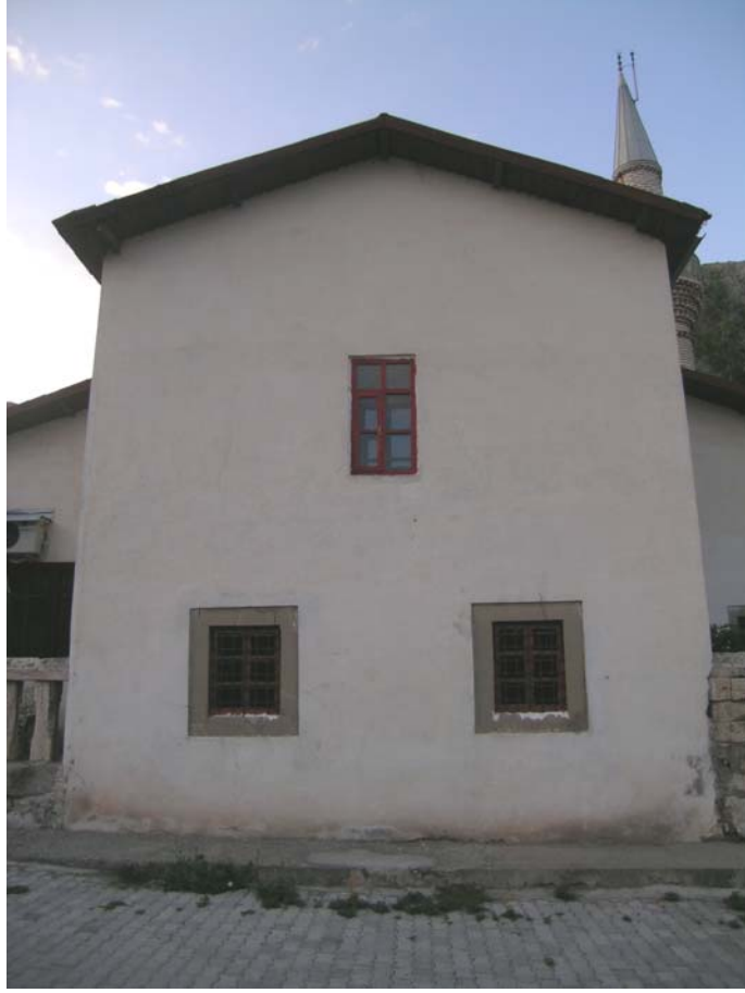
Şekil 6.77 Caminin güney cephesinde yer alan pencere söveleri üzerindeki bozulma
