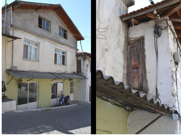
Şekil 5. 19 Tarihi yapılara verilen zarar örneği (2011)
