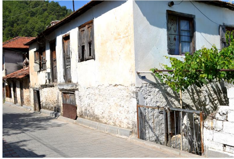
Şekil 5. 21 Yol kotunun artması ile zemin katın yolun aşağısında kalması (2011)
