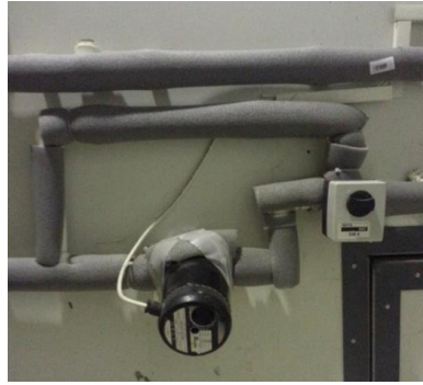
Şekil 3.24 Tesisattaki sirkülasyon Pompası ve üç yollu Vana
