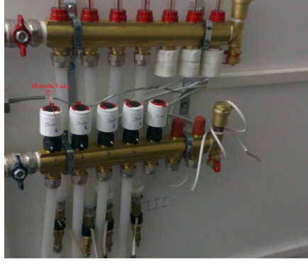
Şekil 3.26 Tesisattaki gidiş ve dönüş kolektörü
