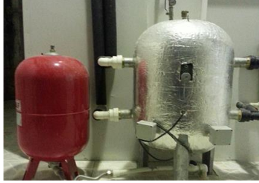
Şekil 3.21 Genleşme tankı ve karıştırıcı tank
