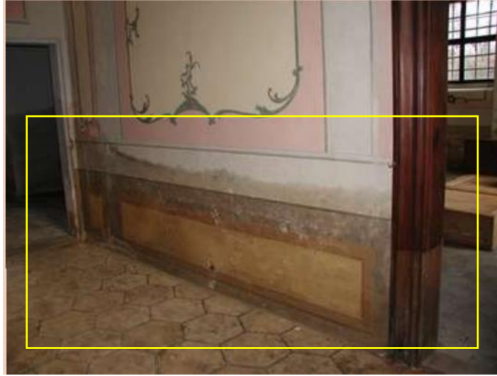
Şekil 3.35 Veltrusy Şatosu iç duvarında su emme kaynaklı hasar (ProteCHt2save, 2018)
