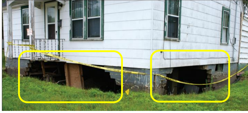
Şekil 3.23 Sel sonrası yapının bodrum kat duvarında oluşan hasar (FEMA, 2012).
