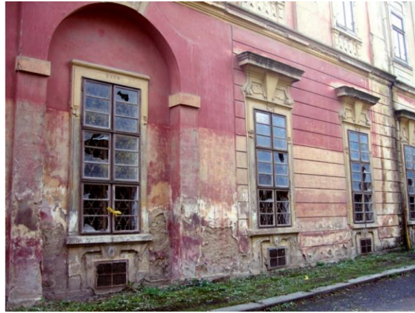
Şekil 3.33 Prag'da tarihi yapı duvarında hasar (Hill, 2016)
