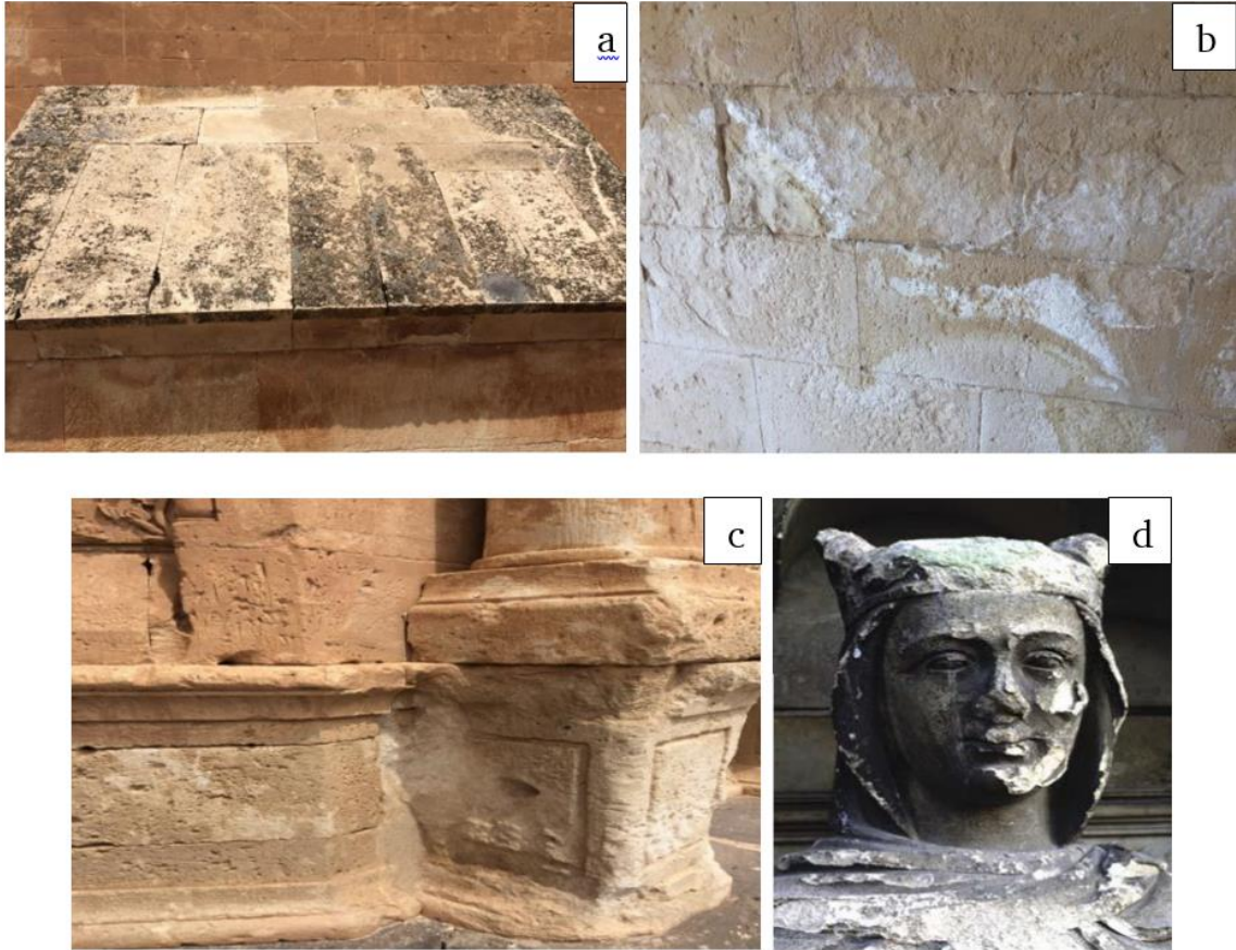
Şekil 2.35 Taş bozulma türleri (a-çiçeklenme b-tuzlanma c-tozlaşma d-kabuk atma) (Artık ve Turan, 2018)
