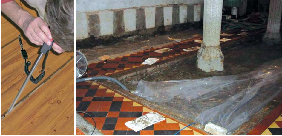
Şekil 3.40 Döşemelerde sel hasarı tespiti ve kurutulması (English Heritage, 2015)
