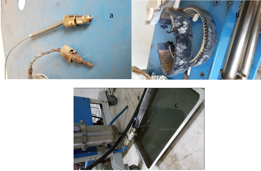
Şekil 5.31 Sistemde yaşanan problemlere örnekler
