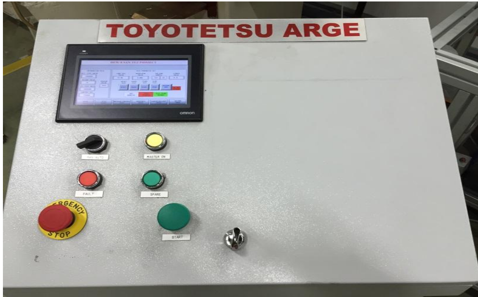
Şekil 5. 3 Test Düzeneği Kontrol Panosu
