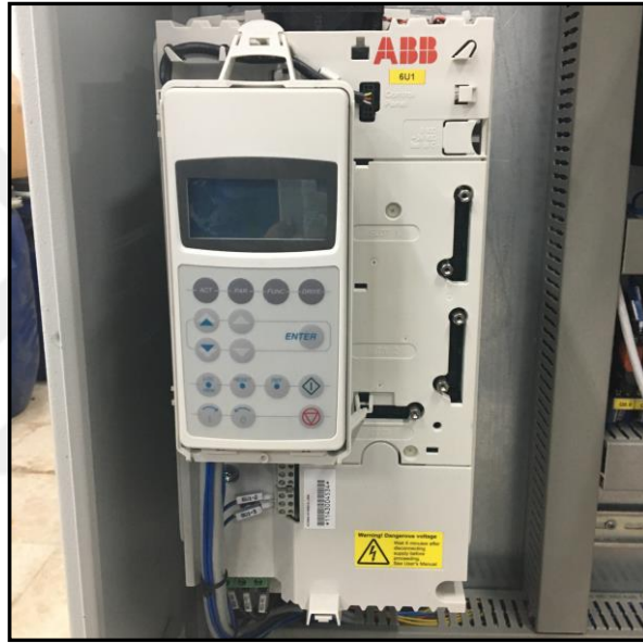
Şekil 3. 6 Elektrik motoru sürücüsü (frekans invertörü)
