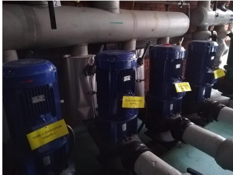
Şekil 4.14 Chiller su pompaları
