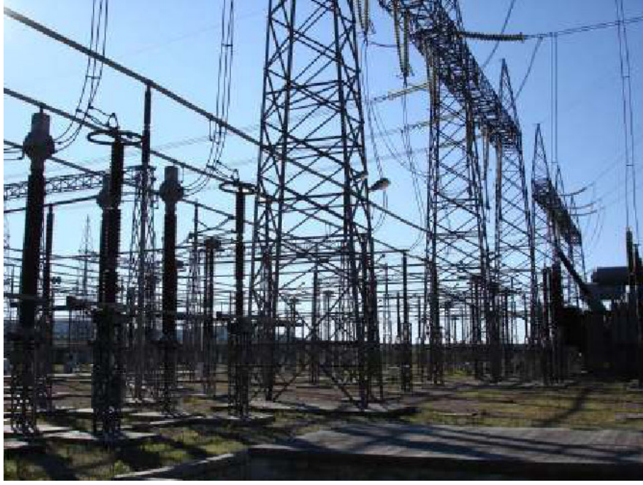
Şekil 6.2. Ölçüm yapılan tesise ait 380 kV'luk şalt merkezinden bir görüntü
