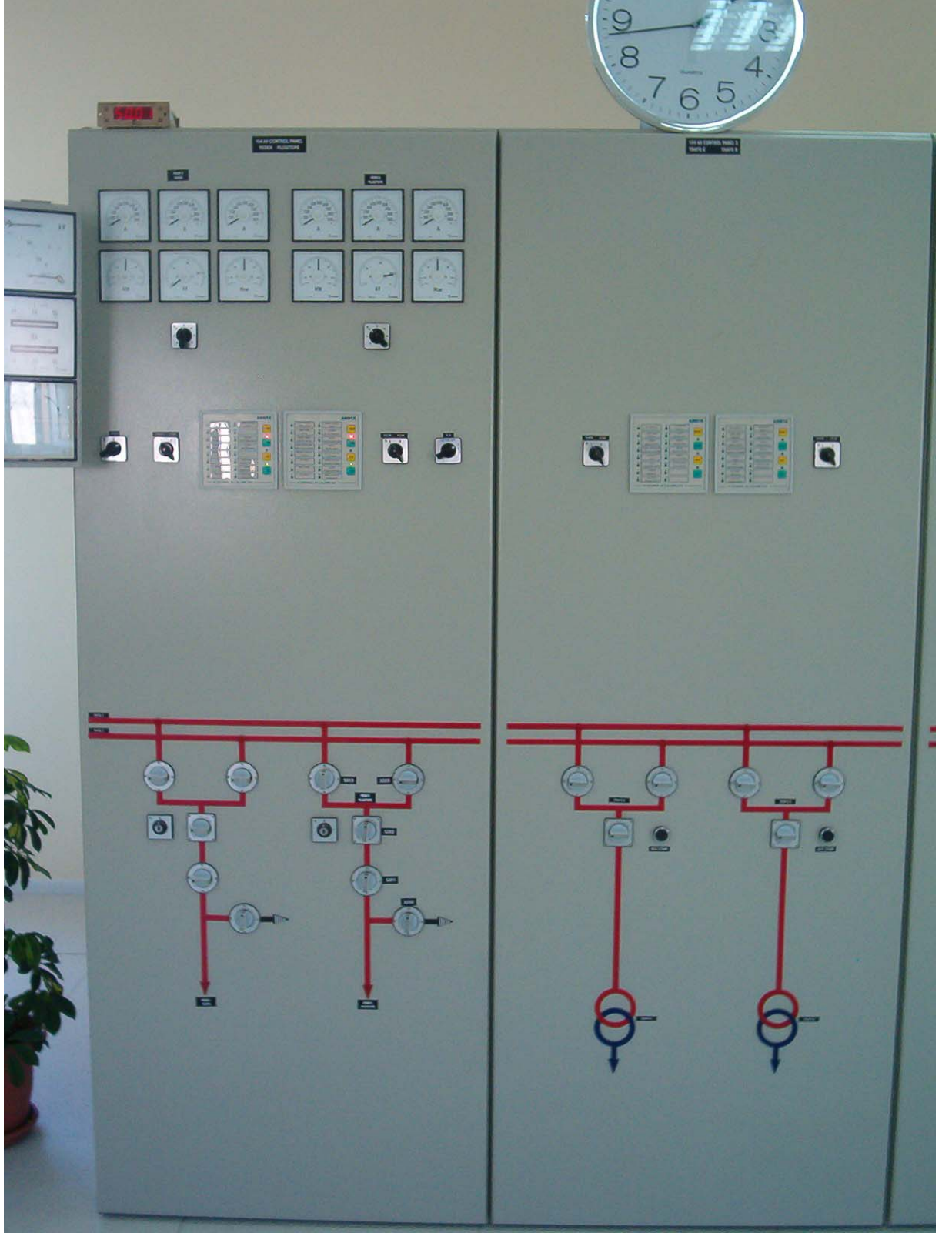
Şekil 7.8 154 kV kumanda panosu
