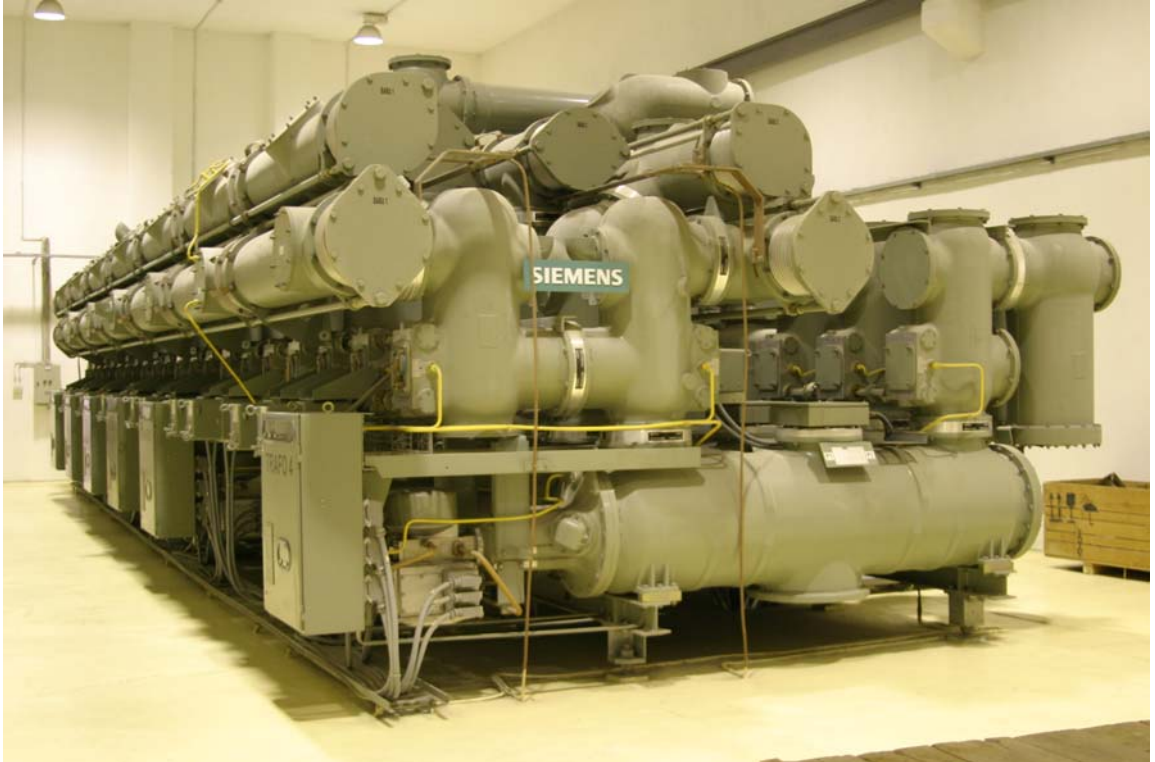
Şekil 7.5 154 kV Levent gaz izoleli şalt merkezi
