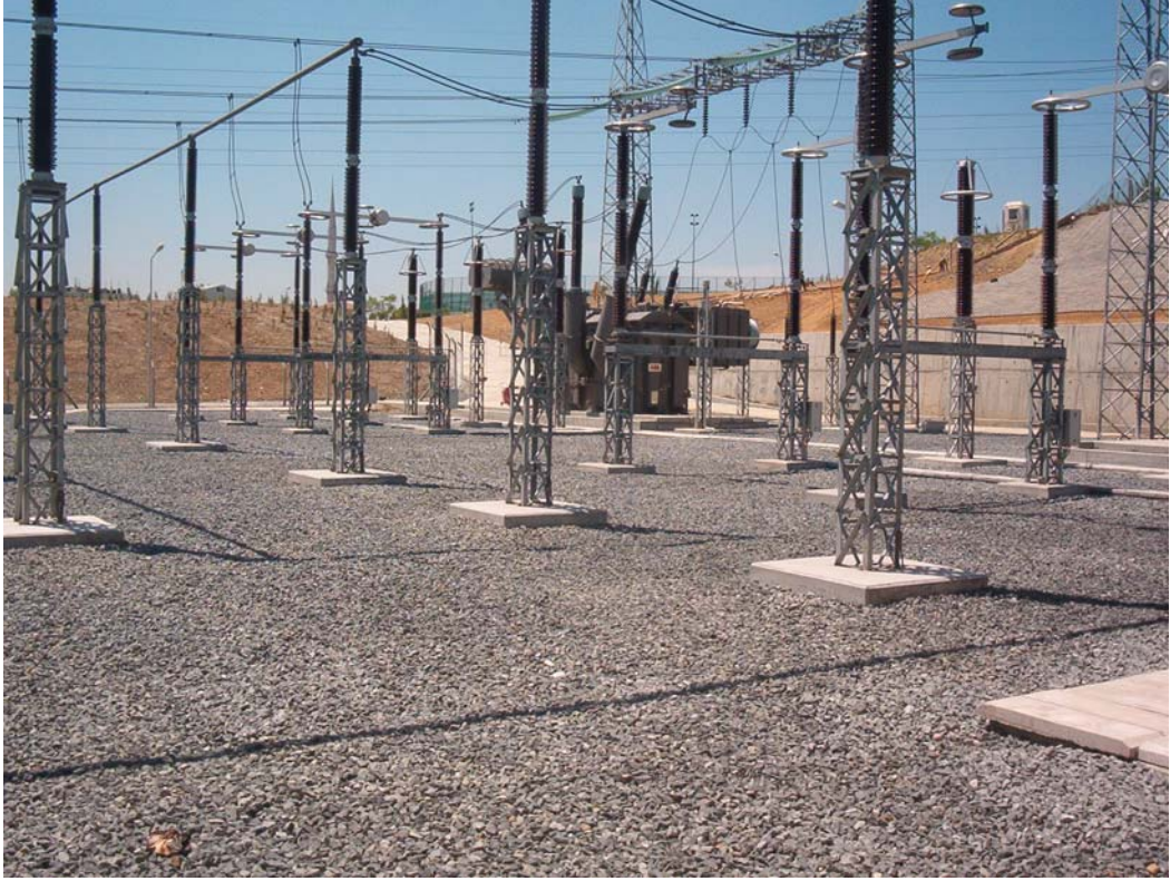
Şekil 7.2 380 kV Atışalanı açık şalt merkezi
