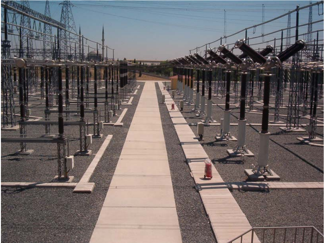
Şekil 7.3 380 kV Atışalanı açık şalt merkezi
