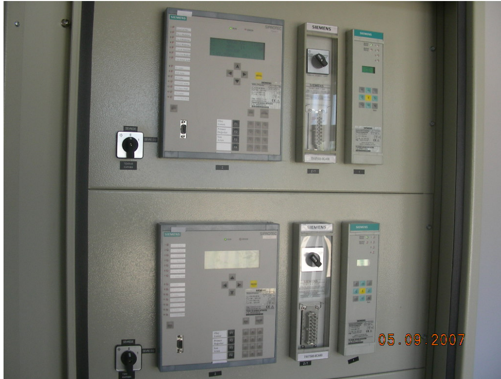
Şekil 7.12 154 kV yeni tip röle panosu
