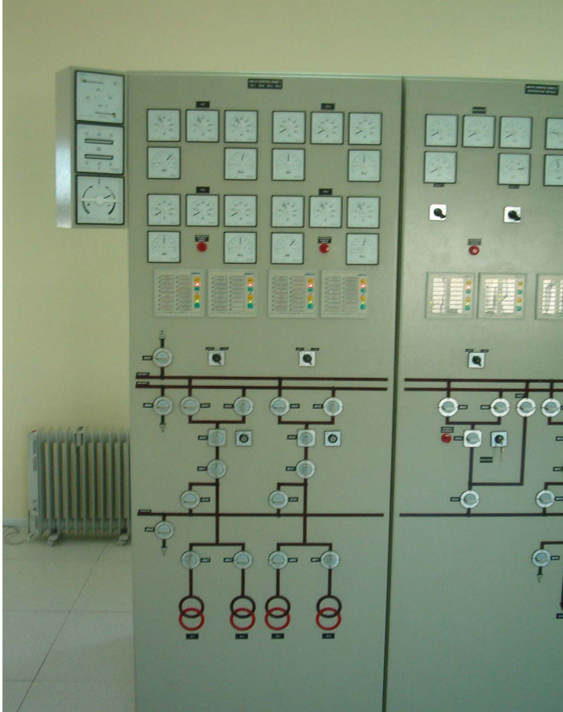
Şekil 7.7 380 kV kumanda panosu
