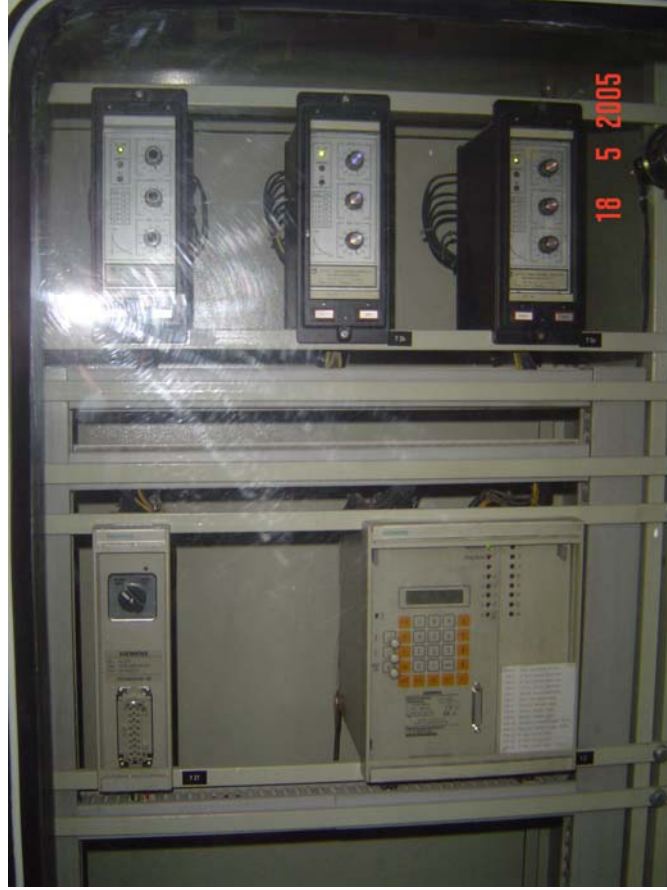
Şekil 7.11 154 kV eski tip röle panosu
