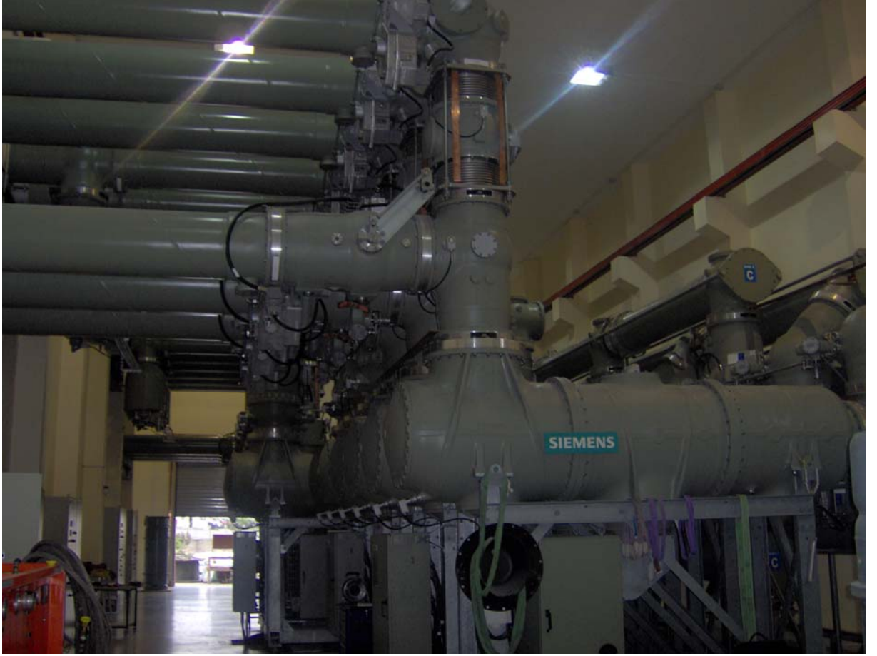
Şekil 7.6 380 kV Zekeriyaköy gaz izoleli şalt merkezi
