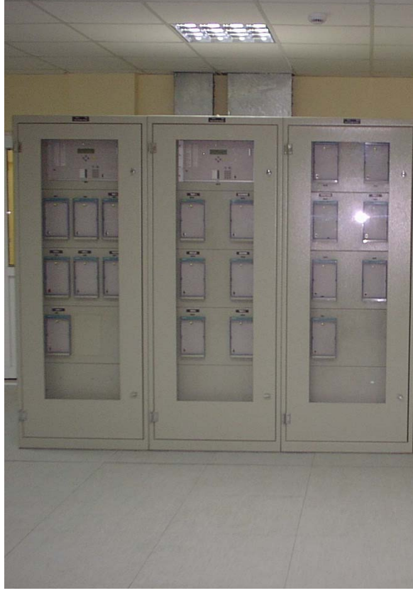
Şekil 7.24 Bara ve kesici arıza koruma panosu
