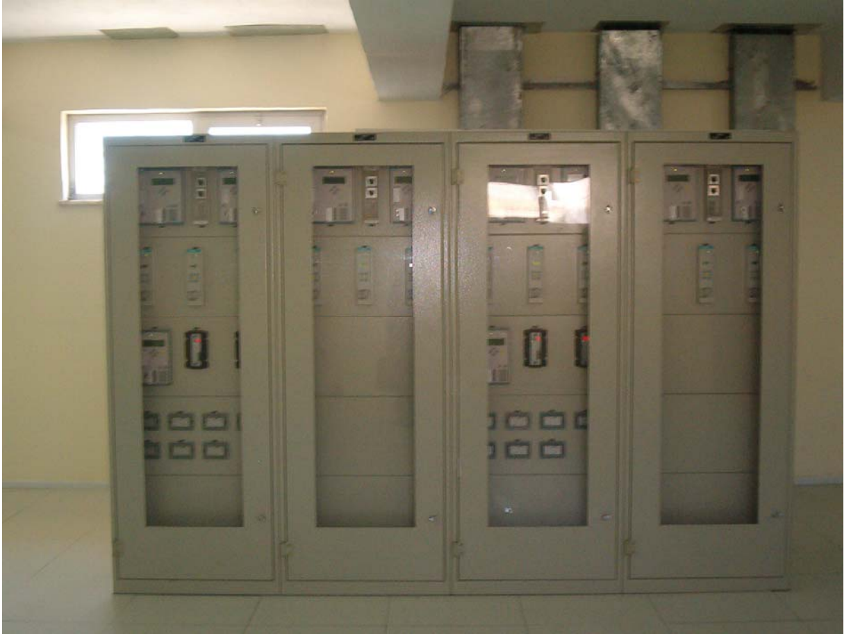
Şekil 7.10 380 kV röle panosu
