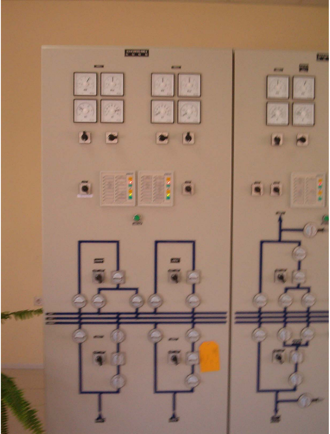
Şekil 7.9 34,5 kV kumanda panosu
