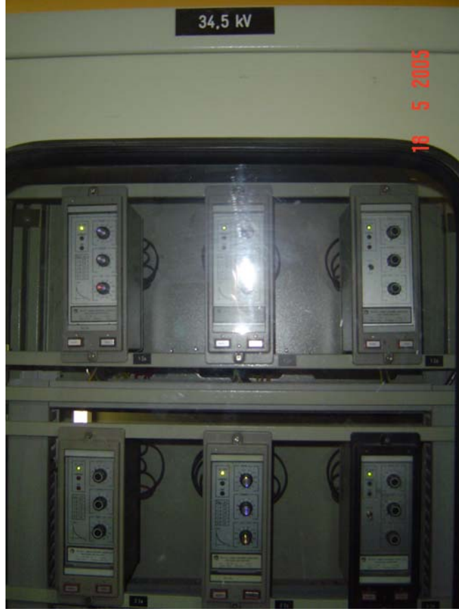
Şekil 7.13 34,5 kV röle panosu
