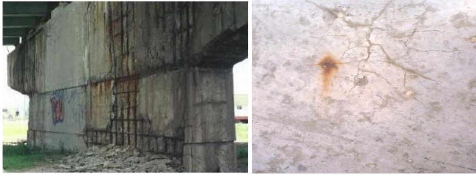
Şekil 1.1 Köprü Ayağında Görülen Hasar [3]. Şekil 1.2 Korozyonun Betonun dışına çıkmaya Başlaması Hali [3].
