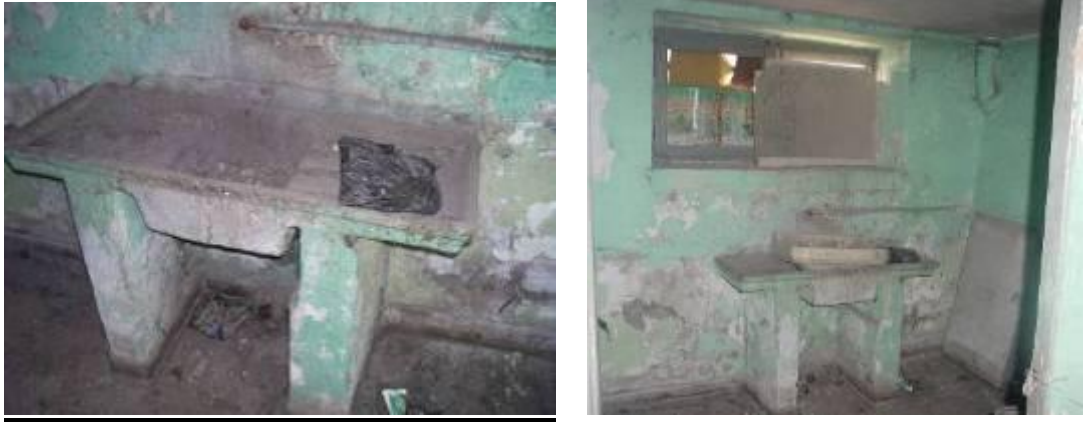
Şekil 4.75 Mutfak mekânındaki eviye. S.K.B.Fabrikası Lojmanları. 1942 3
