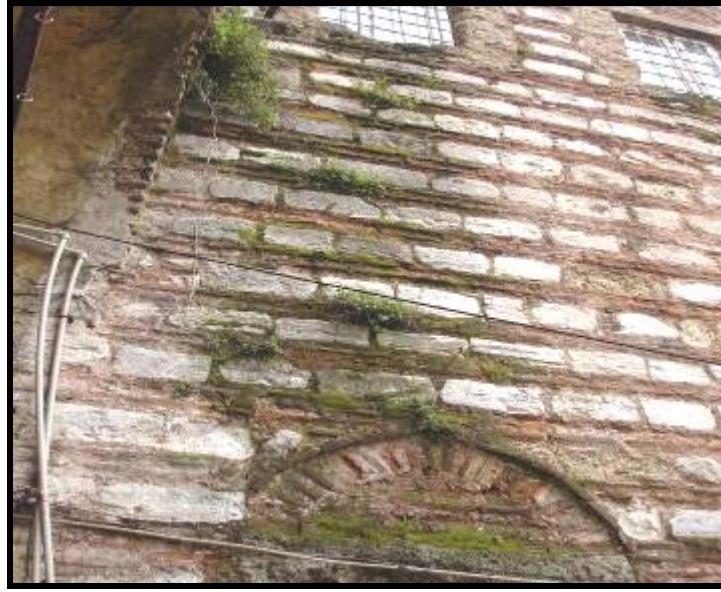
Fotoğraf 6.38 Büyük Yeni Han'ın avlu duvarlarında, çatıdan sızan su ve nemden dolayı yosunlanma ve görülen bitki üremesi
