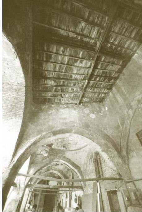
2. avlu 1. kat güney cephesinde yıkılmış üst örtü
