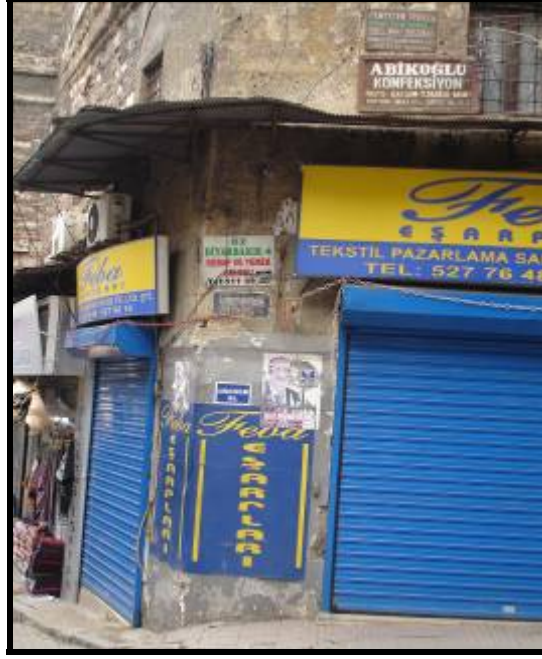
Fotoğraf 6.18 Cephenin boyanması, asılan afişler, reklam tabelaları da cephe malzemesine neden olan tahribatlar
