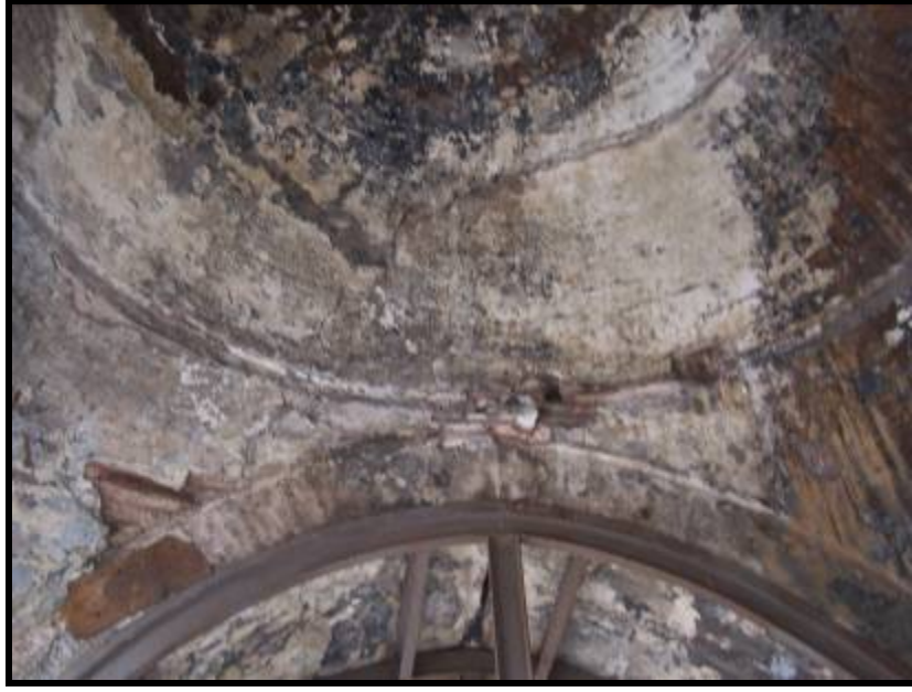
Fotoğraf 6.14 Vezir Han'daki revak kubbelerinde oluşmuş çatlamlar
