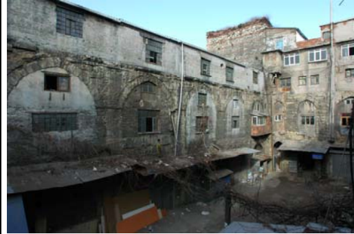
3. avlu, kapatılmış revaklar ve revaklar üzerindeki ek yapı
