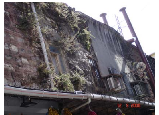
Hasircılar cad. cephesinde oluşan tahribat
