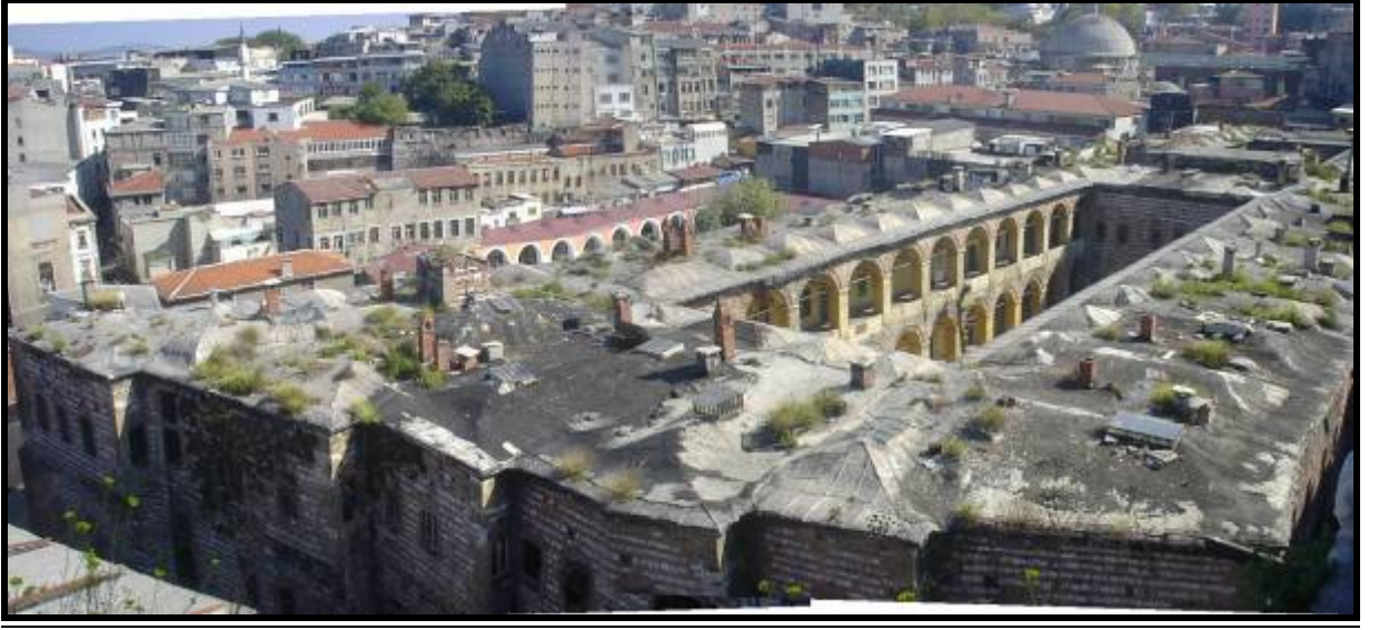
Fotoğraf 6.39 Büyük Yeni Han çatı örtüsündeki tahribatlar
