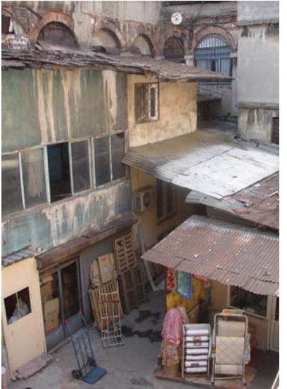
Avluda doğu cephesi revaklarının önüne gelen ek yapı
