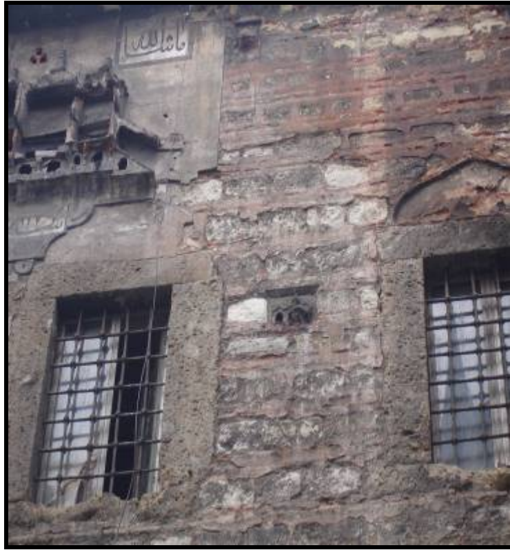
Fotoğraf 6.20 Büyük Yeni Han'ın cephesindeki kuş evinde görülen dökülmeler.
