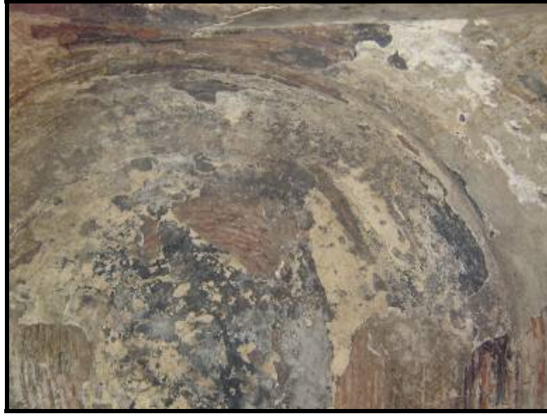
Fotoğraf 6.32 Nemin neden olduğu malzeme bozulmaları (Vezir Han revak kubbesi)
