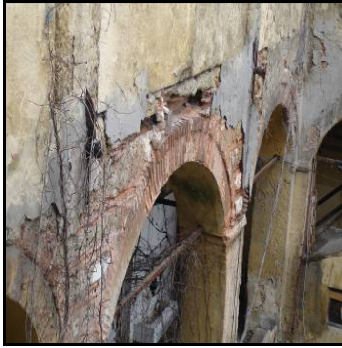
Fotoğraf 6.21 Büyük Yeni Han'ın duvarlarında sonraki dönemlerde yapılan sıvaların, dökülmesi
