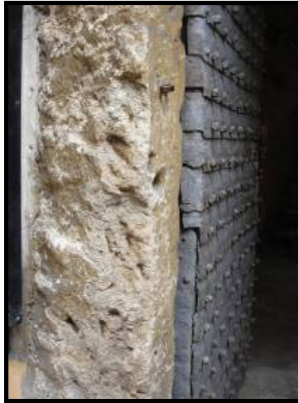
Fotoğraf 6.7 Kapı sövesinde çarpmalar sonucu oluşmuş oyulmalar
