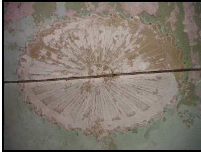
Fotoğraf 6.26 Nem ve yoğunlaşmadan dolayı oluşan bozulma (Yıldız Han)
