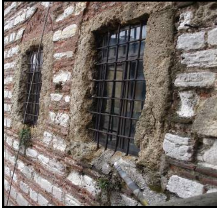
Fotoğraf 6.17 Korozyon sonucunda taş malzemede görülen kopmalar
