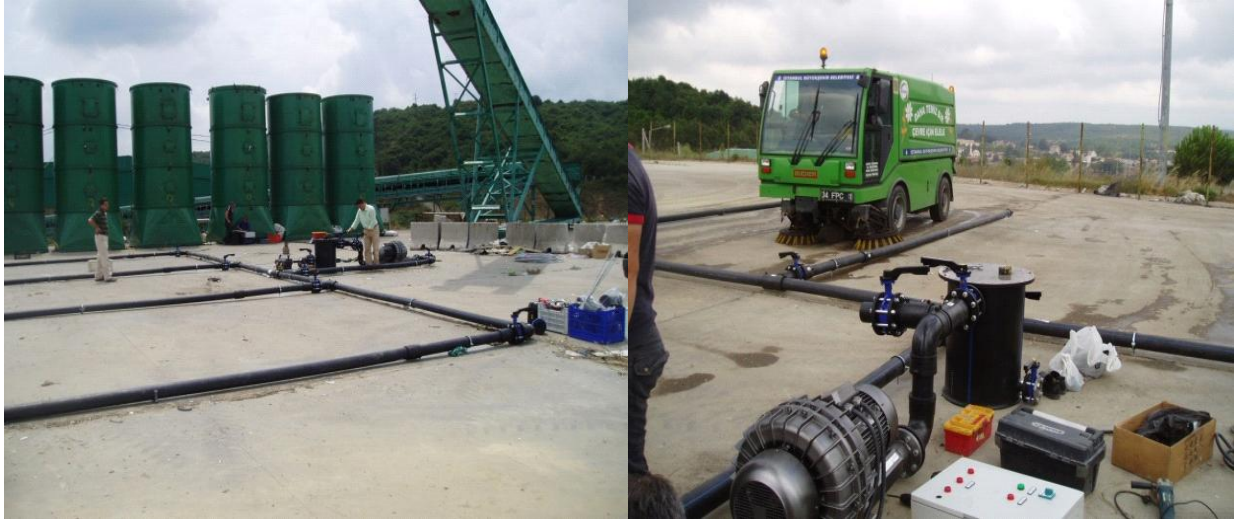
Şekil 5.4 Havalandırma sistemine ait resimler.
