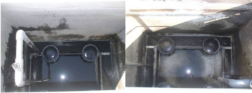
Şekil 3.8 Pilot ölçekli atıksu arıtma tesisi birinci kademe (solda) ve ikinci kademe (sağda) nitrifikasyon üniteleri
