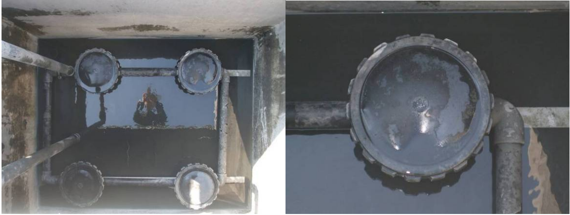
Şekil 3.9 Pilot ölçekli atıksu arıtma tesisi nitrifikasyon kademesi difüzörleri
