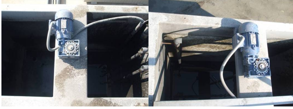
Şekil 3.7 Pilot ölçekli atıksu arıtma tesisi birinci kademe (solda) ve ikinci kademe (sağda) denitrifikasyon üniteleri
