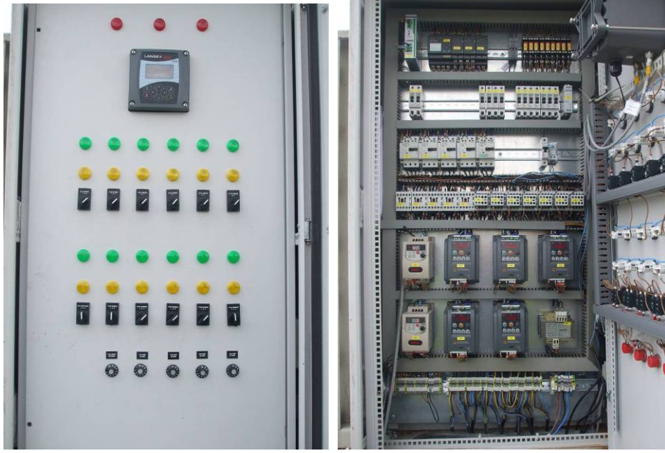
Şekil 3.12 Pilot ölçekli atıksu arıtma tesisi kumanda panosu
