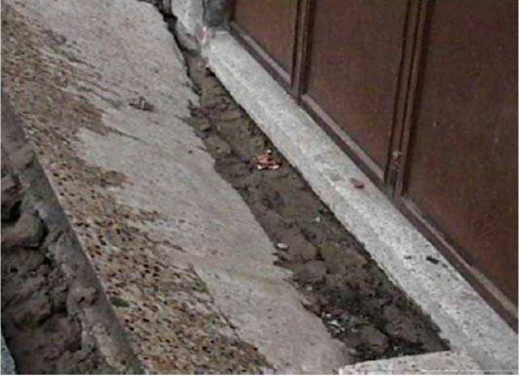
Şekil 1.4 Apartmanın garaj kapısının girişinde deprem esnasında siltli zeminin yüzeye fıskırması ve kaldırımın binaya doğru çökmesi (Ansal vd., 1999)
