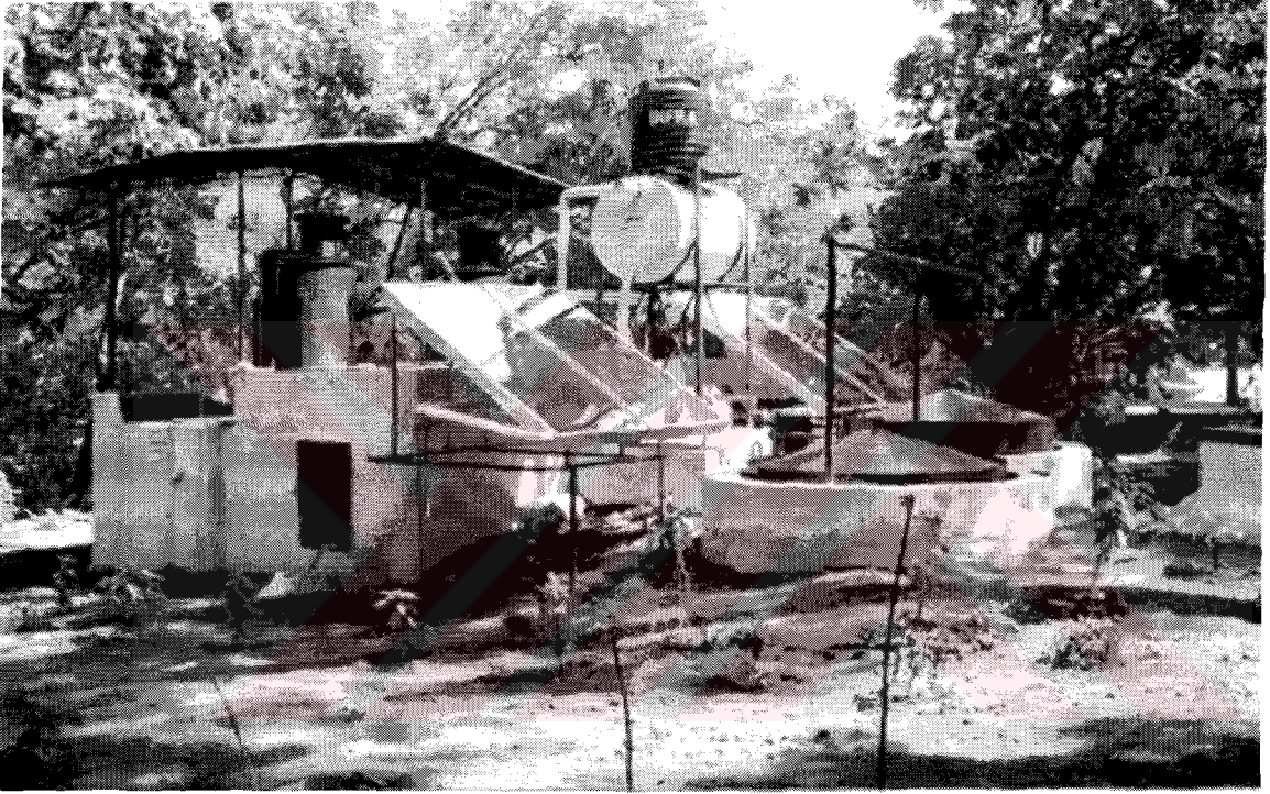
Şekil 3.1 Mutfak atıkları için yapılmış bir biyogaz tesisi ( www.dae.gov.in )
